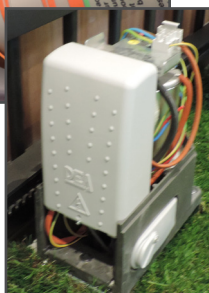
Utiliser les passes câble
